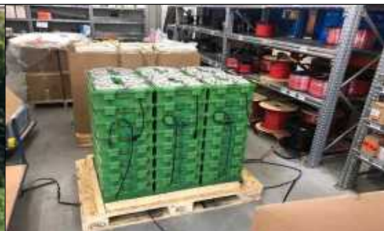
블루 (또는 그린) 배터리 실제 설치모습 (네덜란드 그린빌리지)
